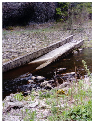
Ancienne passerelle emportée par les crues
